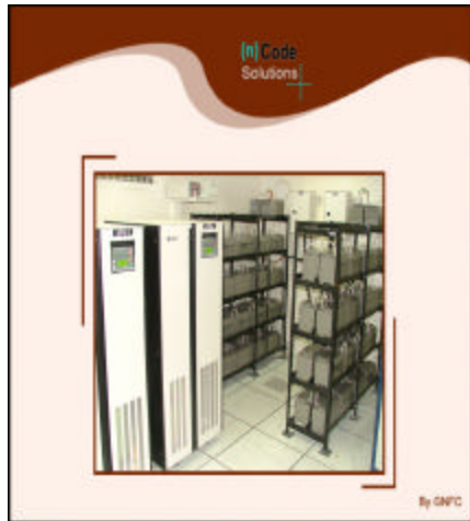
GNFC Data Center
